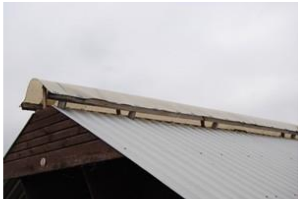
Takåskonstruktion som förbättrar ventilationen.
